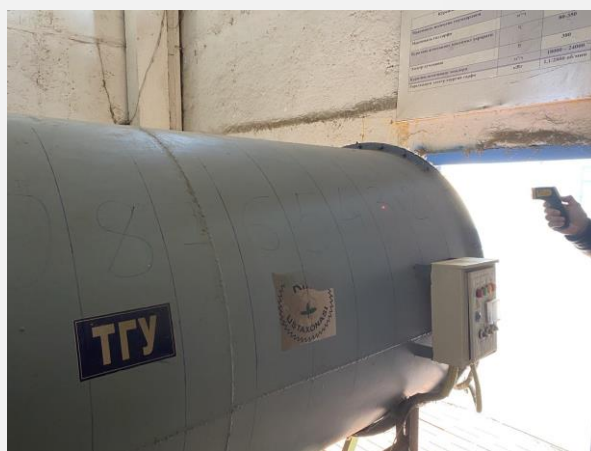
4-рисунок. Процесс измерения температуры нагрева наружного корпуса теплогенератора
